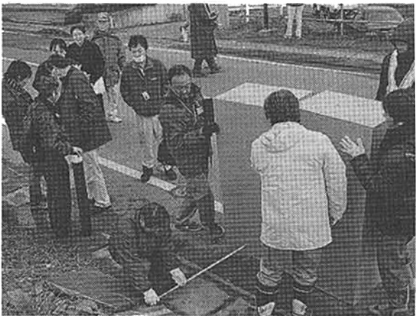
電柱に替わる地上機の模型でふさわしい設置場所を検討する関係者
