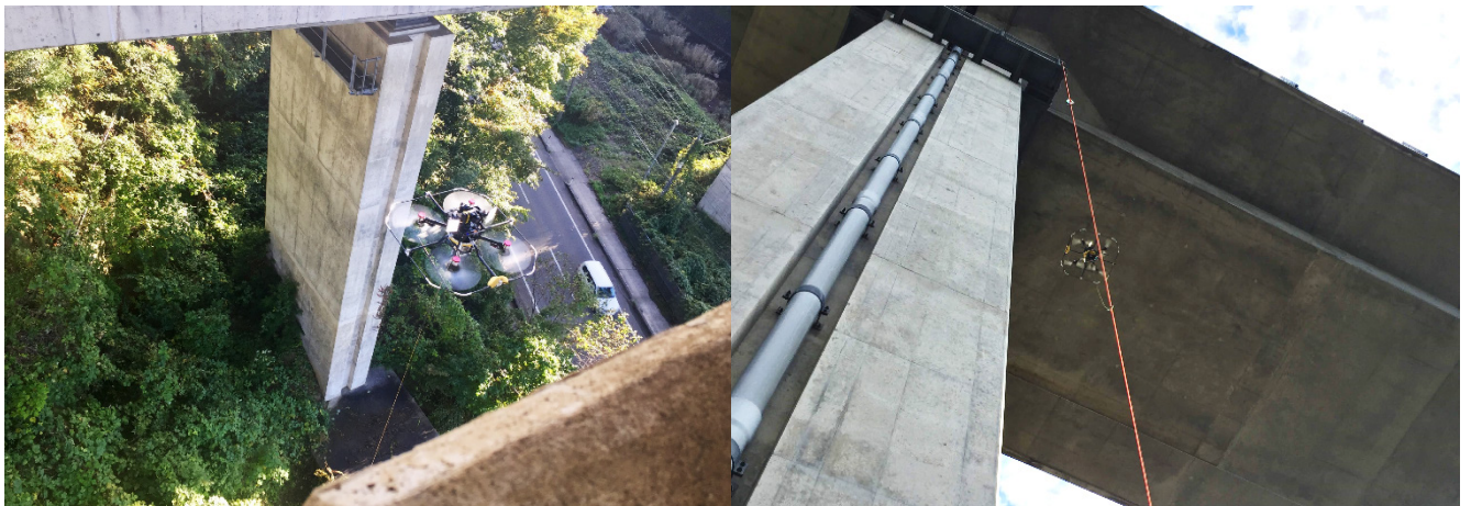
図 特許出願中の飛行安全装置を適用した 県道付近での高橋脚に対する試行状況
